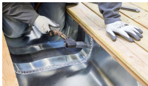
Chéneau Crédit photos VMZINC®
